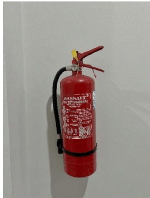
Gambar 8. Alat Pemadam Api Ringan [Sumber: data lapangan, 2024]
