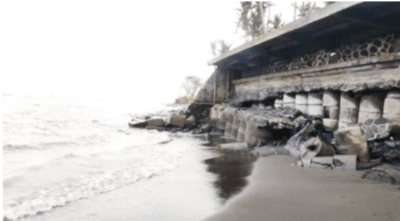
Gambar 10. Rusaknya Talud di Pantai Pabean Sumber : Observasi, 2018
