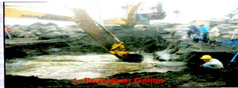
Gambar 7 Pekerjaan Galian pasir campur tanah tempat pemasangan Geotextile Sumber : Kementerian Pekerjaan Umum, Direktorat Jenderal Sumber Daya Air Balai Wilayah Sungai Bali – Penida Propinsi Bali.
