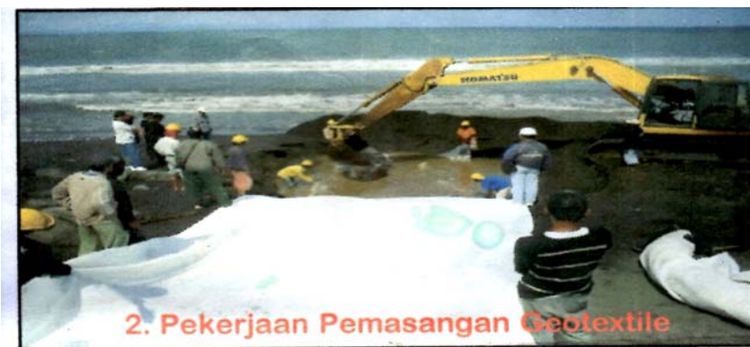
Gambar 8 Pekerjaan Pemasangan Geotextile diatas galian pasir dan tanah Sumber : Kementerian Pekerjaan Umum, Direktorat Jenderal Sumber Daya Air Balai Wilayah Sungai Bali – Penida Propinsi Bali.
